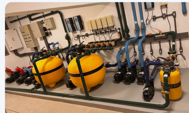
Casa de máquinas
